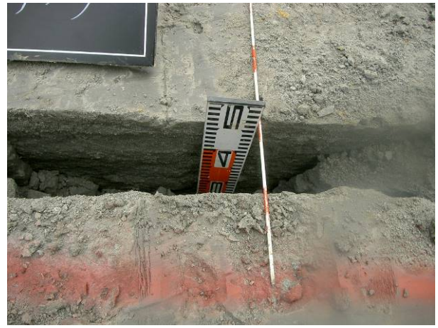
写真.5 滑落崖後方の岩盤に見られる節理面の開口
