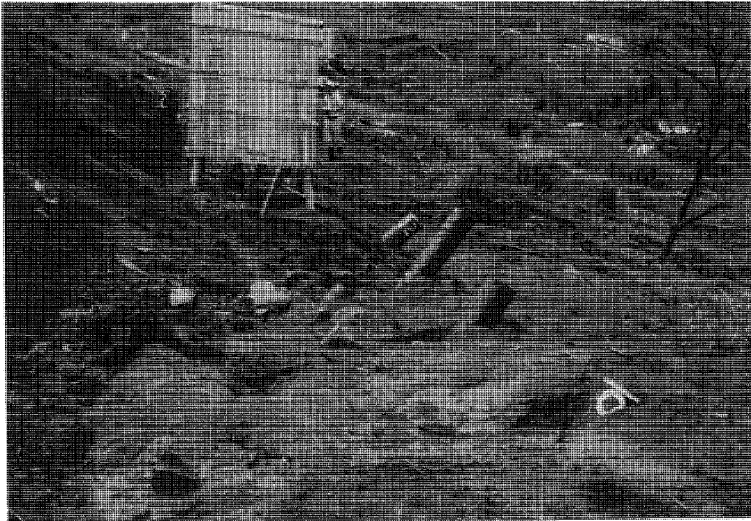
写真 2.6.31 鋼管杭頭変位
